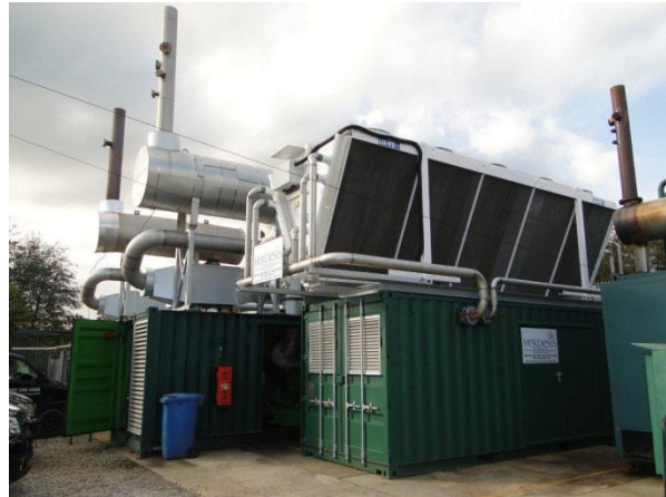
Abbildung 57: ORC-System mit R245fa (vorderer Container) und Biogasmotor (hinterer Container) einer Mülldeponie in Warrington, U.K. (Quelle: Verdesis Services UK Limited)
