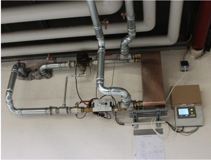
Abbildung 14: Übergabestation des Heizsystems einer Biogasanlage in Deutschland (an der rechten Stelle der Leitungen befindet sich der Wärmetauscher (Quelle: Rutz)
