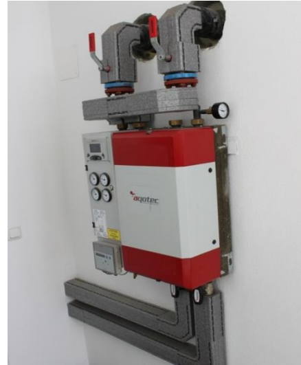
Abbildung 15: Übergabestation mit Wärmetauscher am Endverbraucher, welcher an ein Nahwärmesystem im Achantal, Deutschland, angeschlossen ist (Quelle: Rutz)
