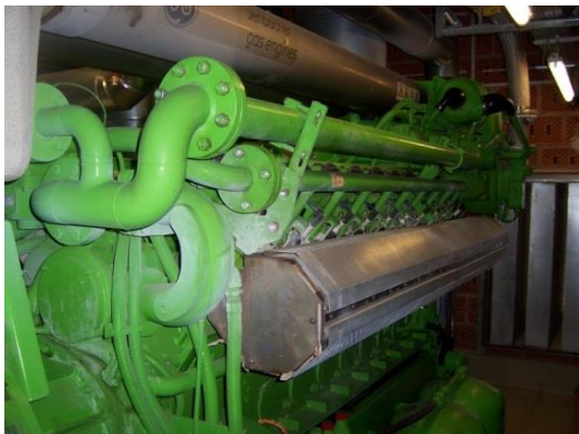
Abbildung 9: Gas-Ottomotor einer Biogasanlage in Deutschland (Quelle: Rutz)
