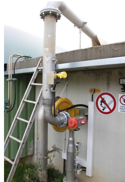
Abbildung 64: Anfang einer Biogasleitung mit Gebläse zu einem Satelliten-BHKW in Deutschland (Quelle: Rutz)
