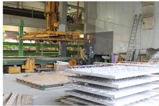
Abbildung 35: Fertige Betonelemente (im Vordergrund) werden von der Trocknungskammer entnommen (Hintergrund) (Quelle: Rutz)
