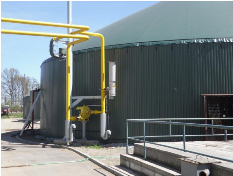
Abbildung 63: Anfang einer Biogasleitung, welche zu einem Satelliten-BHKW im tschechischen Trebon führt (Quelle: D. Rutz)
