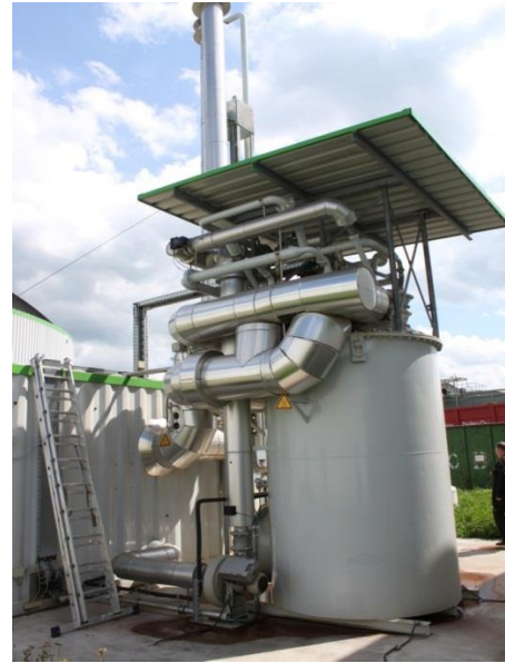
Abbildung 4: Schwachgasbrenner einer Biogasaufbereitungsanlage für die Fermenterheizung in Aiterhofen, Deutschland (Quelle: Rutz)
