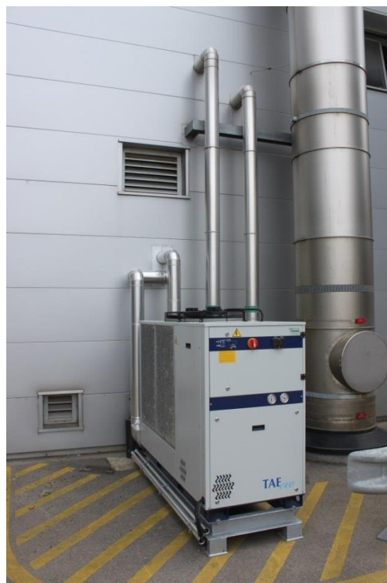
Abbildung 53: Luftkühler der die Abwärme einer Müllverbrennungsanlage in Österreich verwendet (Source: Rutz)
