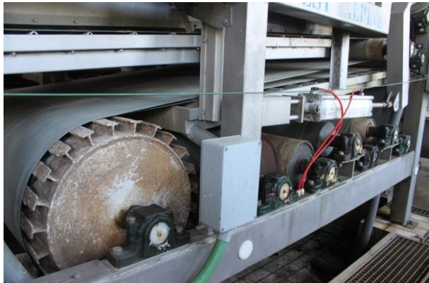
Abbildung 40: Bandrockner zur Trocknung von Gärresten während Wartungsarbeiten (Quelle: Rutz)
