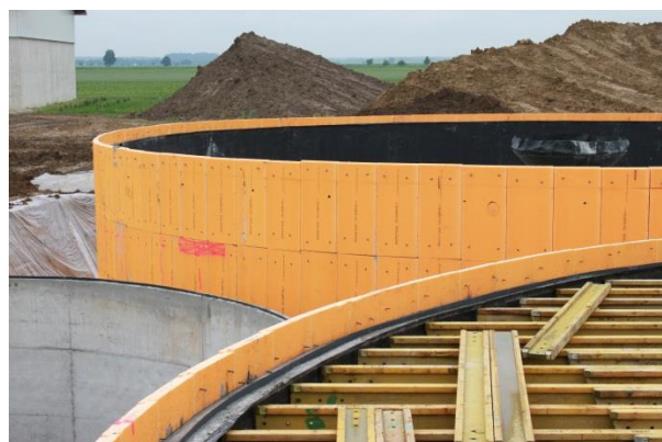
Abbildung 7: Isolierung (orange Dämmplatten) eines Fermenters in Reichenkirchen, Deutschland (Quelle : Rutz)
