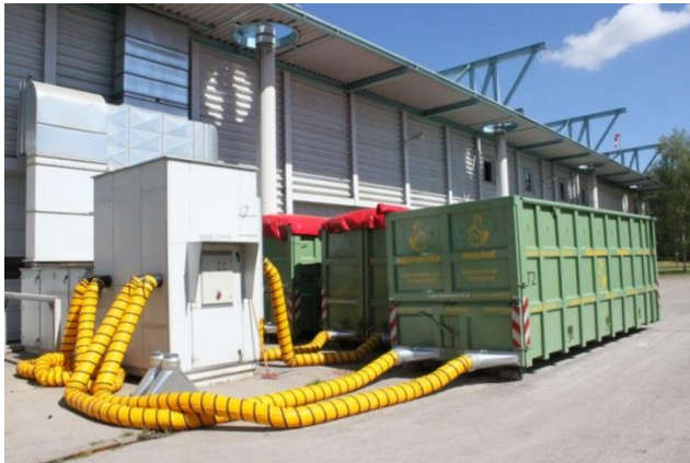
Abbildung 46: Container und Heißluftleitungen für die Holzhackschnitzeltrocknung in einer Biogasanlage in München, Deutschland (Quelle: Rutz)
