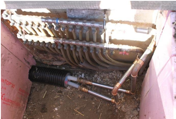
Abbildung 16: Installierte PE Doppelleitung für Fermenterheizung (Quelle: Rutz)
