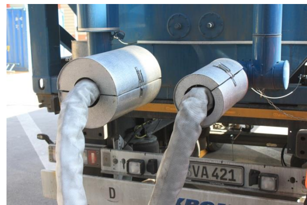
Abbildung 33: Isolierte Andockstation des Wärmespeichers (Augsburg, Deutschland) (Quelle: Rutz)
